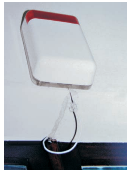
Fot. 1. Widok sygnalizatora i przewodów po włamaniu
